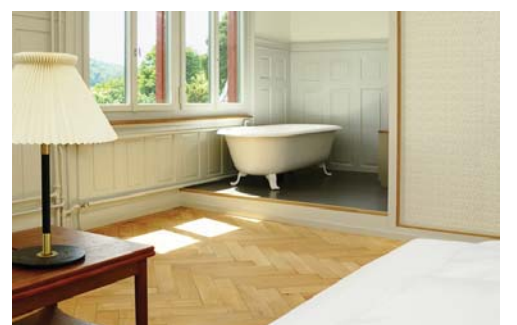
Aus Kostengründen und um die Eingriffe in die historische Bausubstanz gering zu halten, wurden die Sanitärleitungen der neuen Hotelzimmer in einem Podest eingebaut. Foto Eva Olibet.
