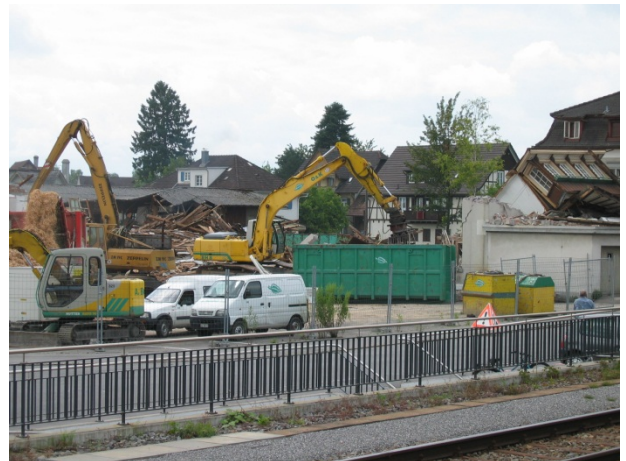
Abb. 24: Der Baggerzahn schafft Platz für eine neue Zukunft. Wird sie 100 Jahre bestehen?
